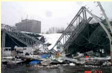
Obr. 2 – Zhroutilá střecha haly Katovice (prolomený hlavní nosník)
