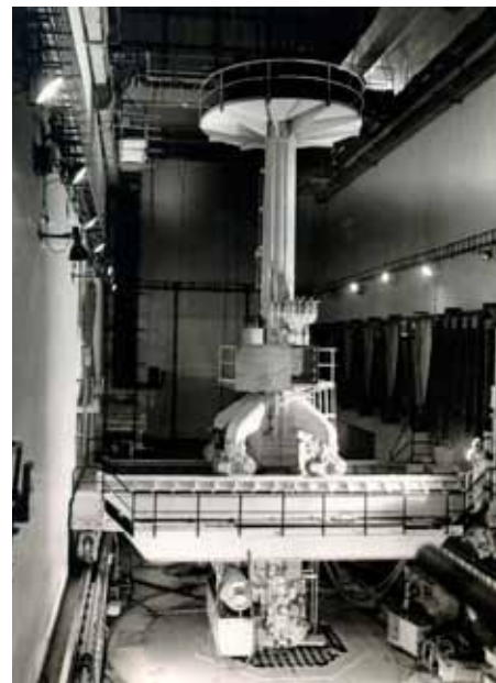
Pohled na zavazovací stroj v reaktorovém sálu jaderné elektrárny A1
