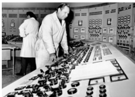
Velín jaderné elektrárny Jaslovské Bohunice A1, která byla 25. prosince 1972 přifázována k síti / Zdroj: JAVYS
