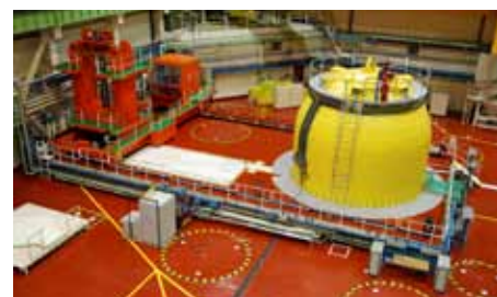
Reaktorový sál jaderné elektrárny Jaslovské Bohunice V1
